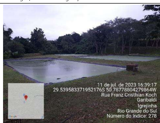
Fotografia 10-10 – Lagoa para tratamento de chorume
